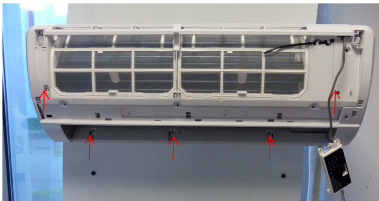
E : Débrocher les 4 ergots qui se trouvent au –dessus du bloc filtre
