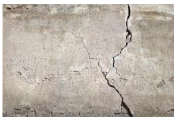
Chapes fissurées et/ou granuleuses
